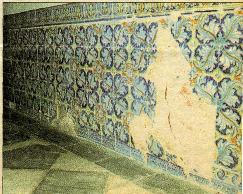
La falta de saneamiento en el subsuelo hace que el agua suba por las paredes
